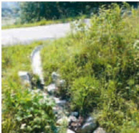
Fallenfreie Entwässerung: offene Regenwasserableitung in den Höcklerbach.
